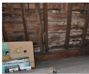
afb. 29 Detail dakopbouw, ontbrekende en beschadigde beboring.
